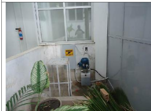
Foto 009 – Vista do motor e caixa de comando.
